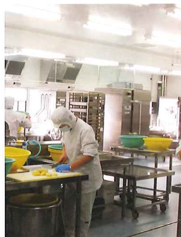
オール電化の調理室
