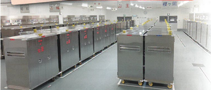
和え物室には真空冷却機3台と スチコンもあります。
