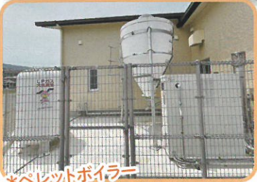
*ペレットボイラー
